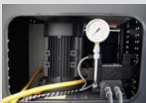
Zweikreis hydraulikaggregat im Schrankunterbau
